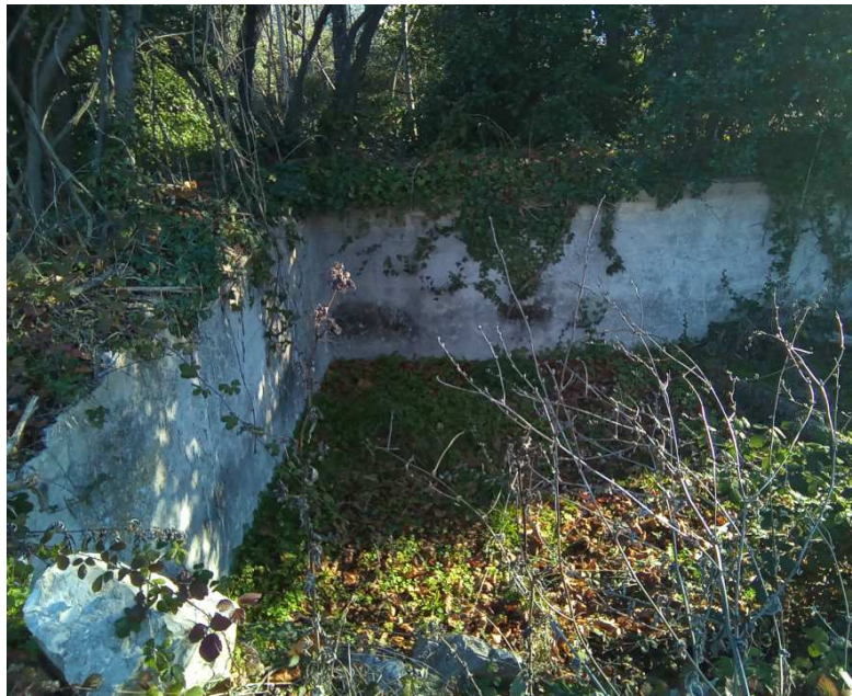
Photo 1 : Bassin en ruine
