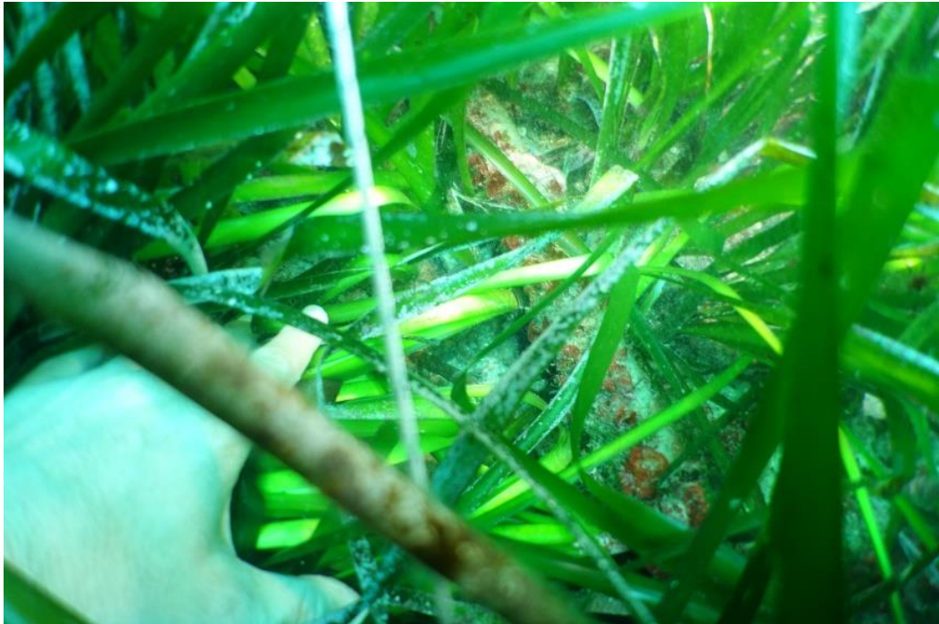
Figure 50 : Câble télécom au sein d'un herbier entre les faisceaux de posidonie (Marseille, 2020)
