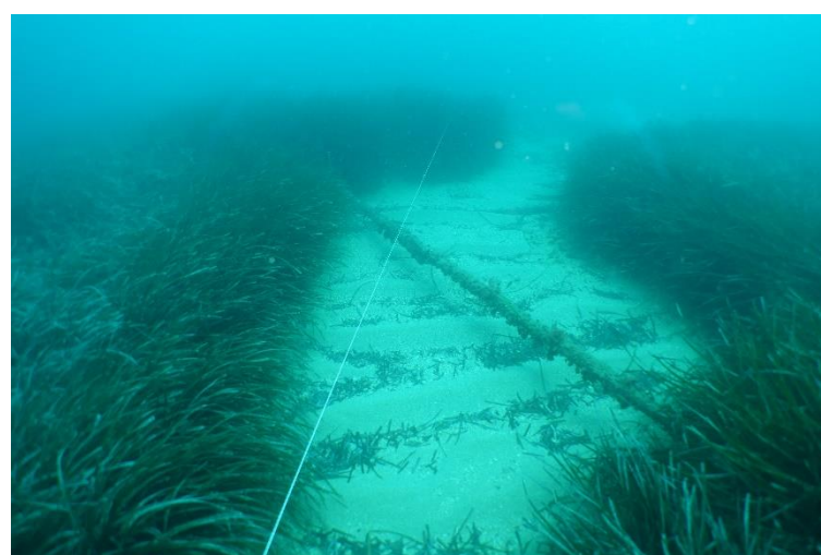
Figure 55 : Câble télécom en suspension au passage d'une zone d'intermatte (Marseille, 2020)
