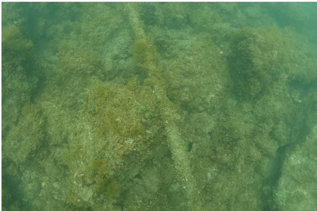
Figure 51 : Câble télécom sur des enrochements (Marseille, 2020)
