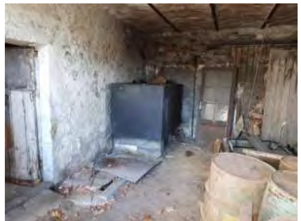
Ancienne cuve à fioul – habitation 2
