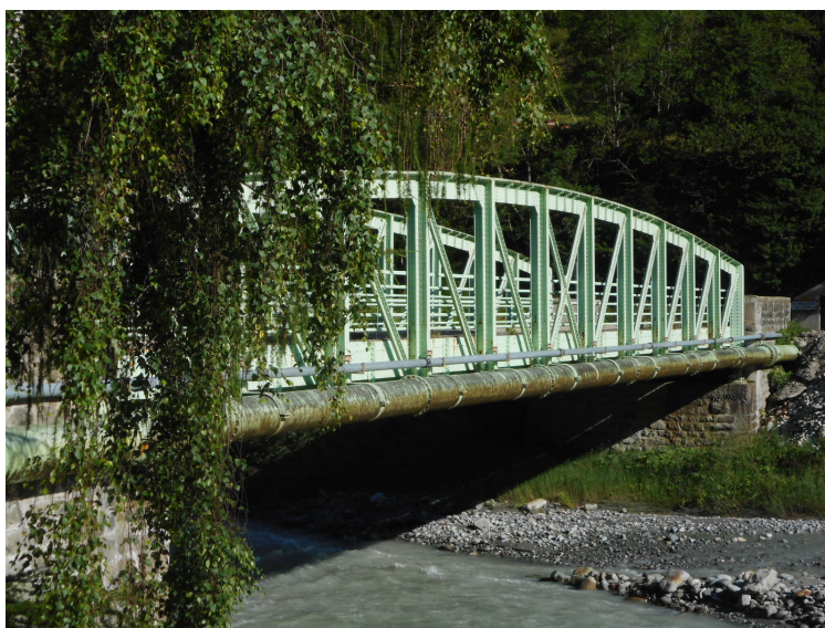
Traversée de la Séveraise au niveau du Pont du Roux et ouvrage d'alimentation
