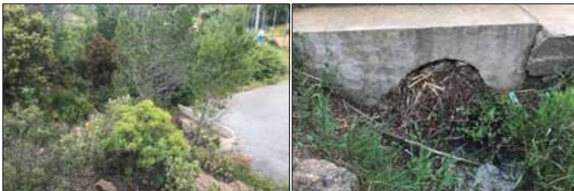
Vue de la buse 1000 mm collectant l'axe d'écoulement avant la traversée du terrain sportif
