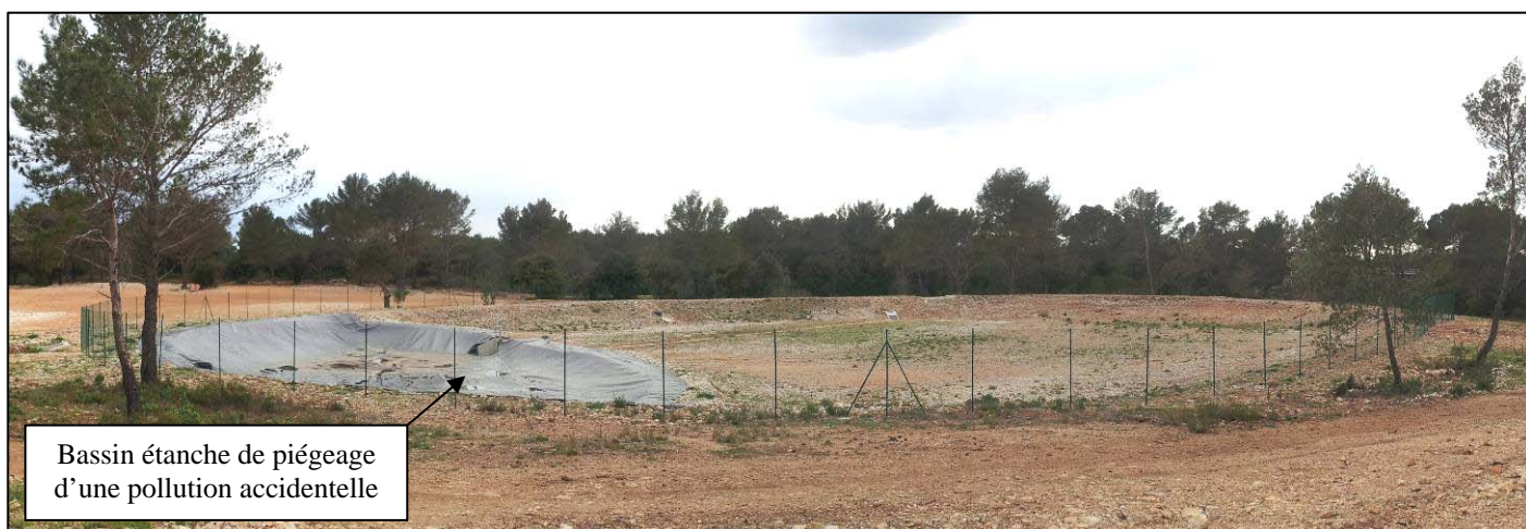
Photographie 1 : Vue vers le Sud-Ouest à l'extérieur du bassin de rétention RET3.
