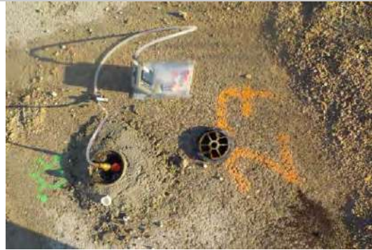
Vue générale du dispositif de prélèvement (point de prélèvement jusqu'à la pompe)
