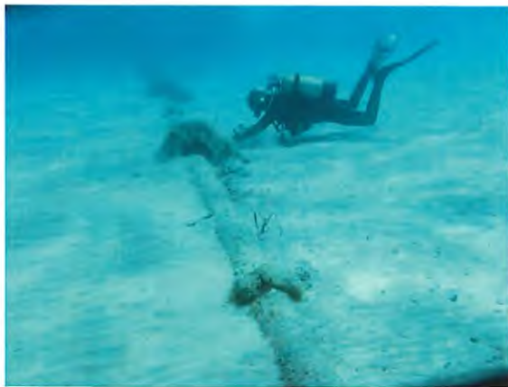
Canalisation sur T1, avec supports de fixation abritant une ponte de céphalopodes.
