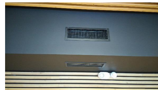
Vigilance sur le bruit des équipements de ventilation
