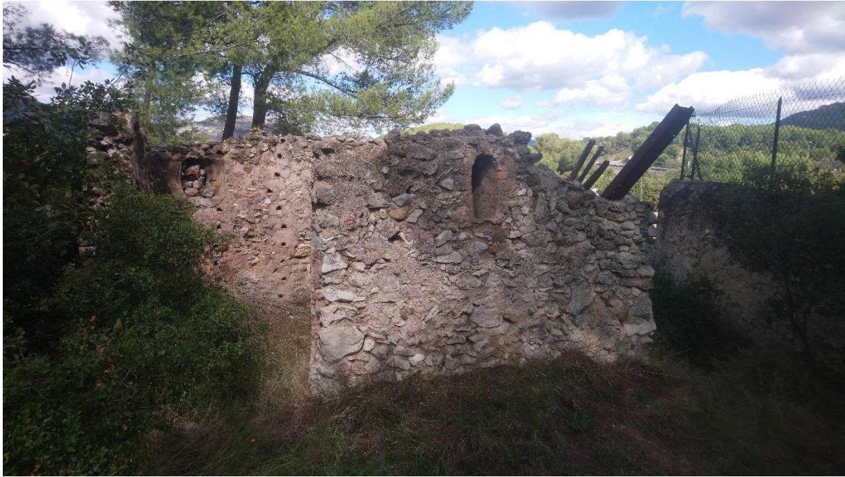
Figure 20 : Habitation en ruine présente sur l'aire d'étude (Source : A. BERTOUX pour Ecotonia)
