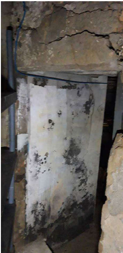
Figure 5 : entrée vers le puits de pompage
