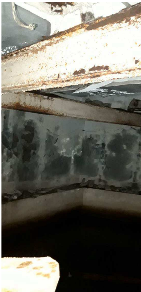
Figures 10, 11 et 12 : Structure couvrant le puits en très mauvais Etat : béton très détérioré et aciers corrodés
