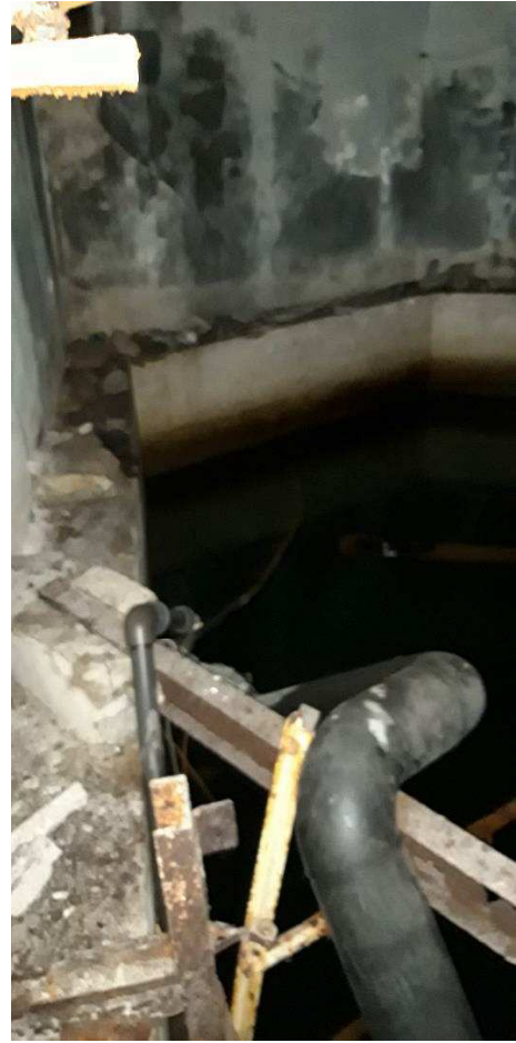
Figure 9 : vue latérale gauche à l'entrée du puits, toutes les canalisations sont découpées et abandonnées et les supports métalliques très corrodés
