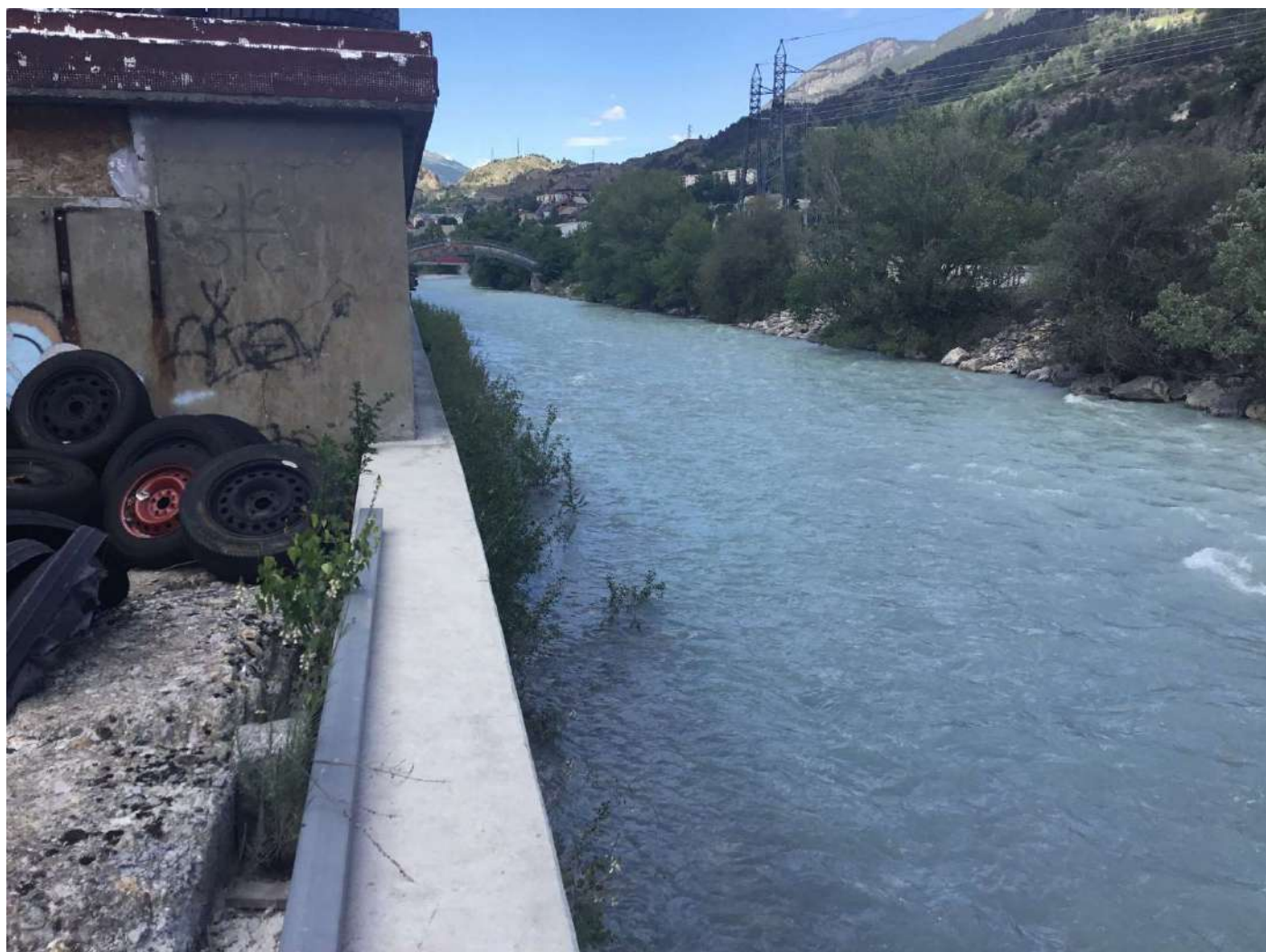
Photo 3 : Digue Rive Droite Aval
