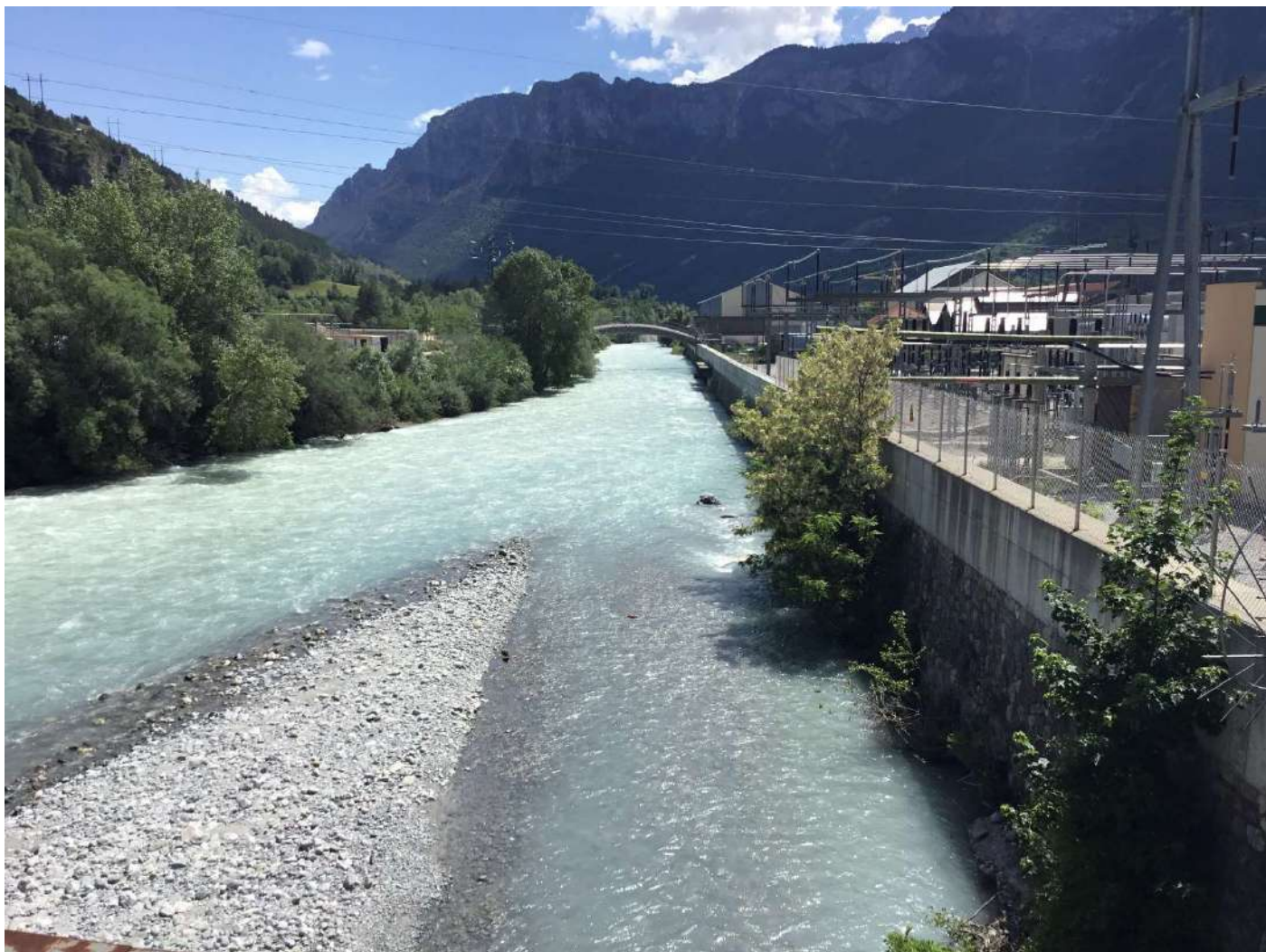
Photo 2 : Digue Rive Droite Aval
