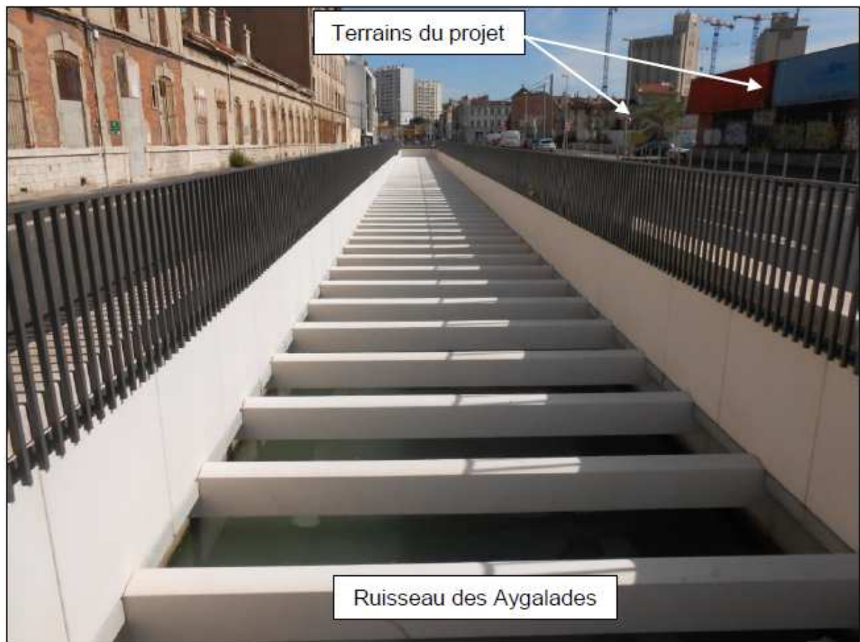
Figure 25 : Trémie du ruisseau des Ayalades au droit de la zone d'étude - Source : Etude vulnérabilité Ingérop
