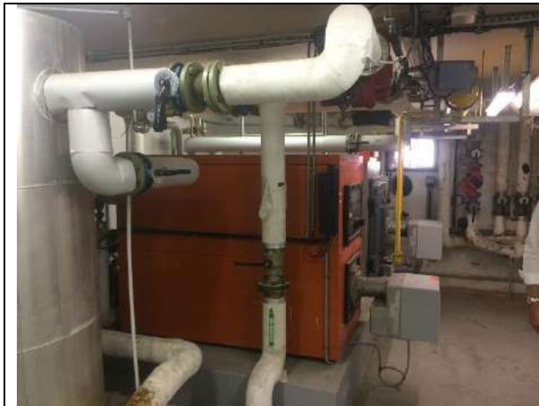
Chaufferie gaz sous la chapelle
