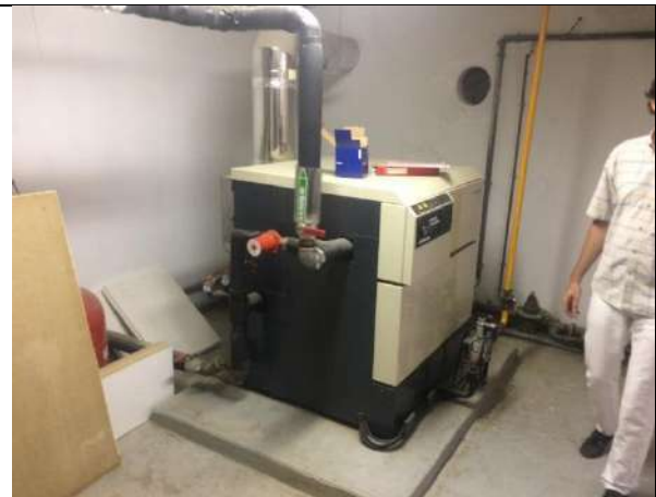
Chaufferie gaz de l'archeveché
