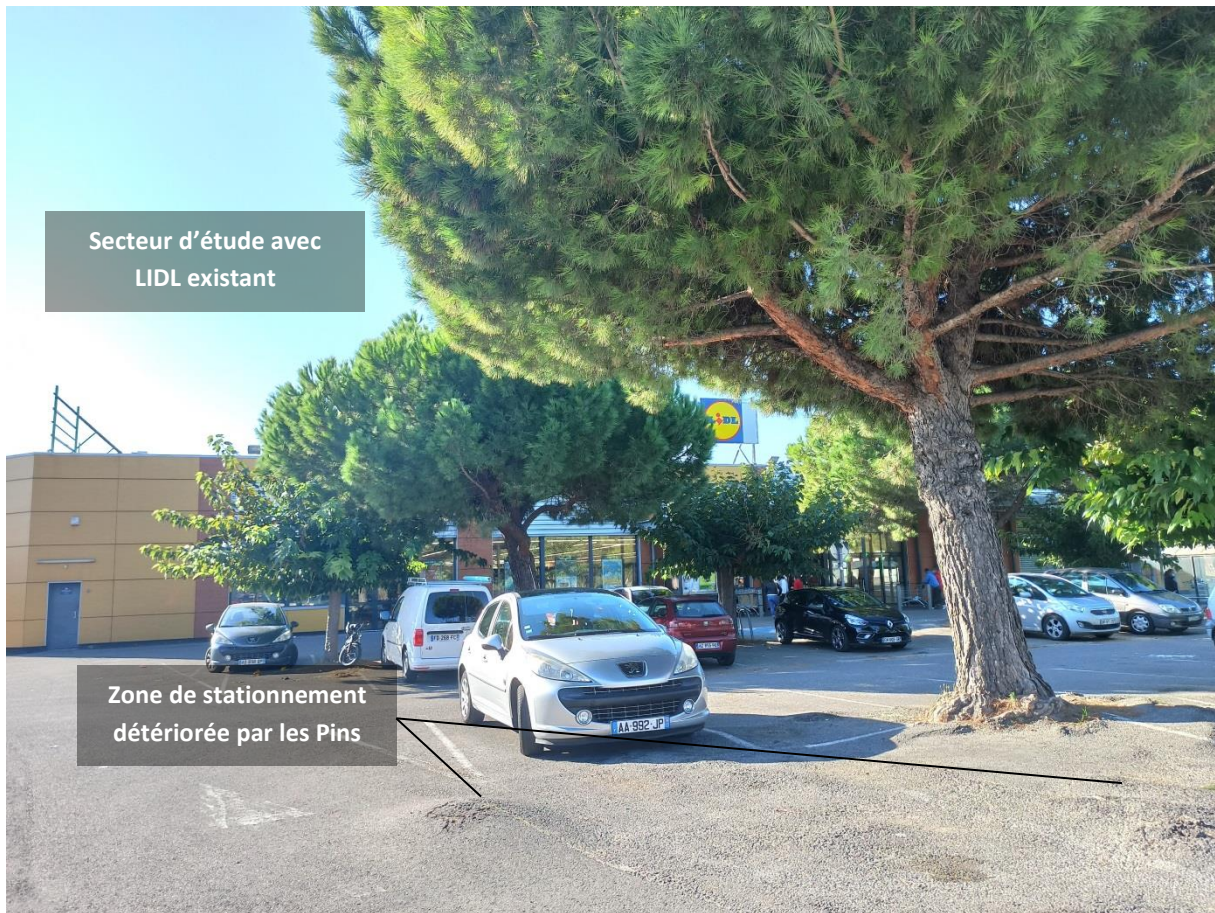
Photo 4 : Vue n°3, sur l'entrée du LIDL existant, avec mise en évidence des zone détériorées par l'implantation des Pins (EVEN, Octobre 2020)
