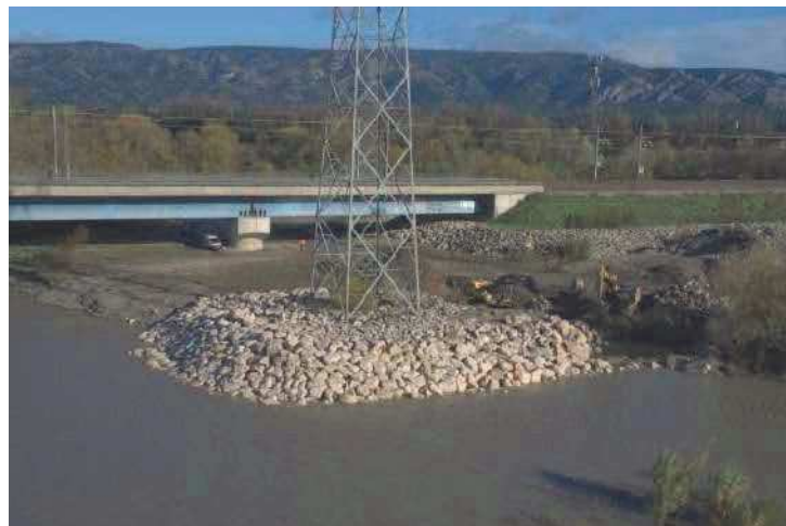
Exemple d'enrochements E-S1 existants sur le pylône 180, non concerné par la demande
