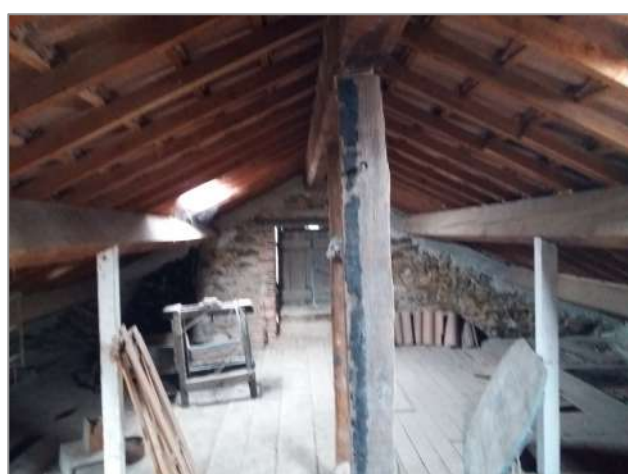
Photo 4 – Comble de la bâtisse sans ouvertures
