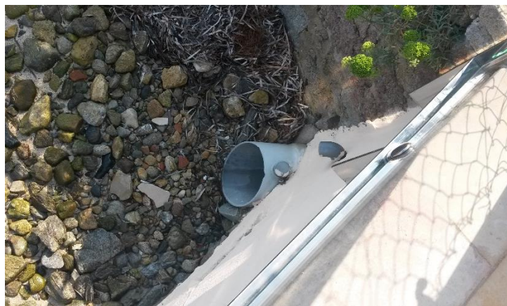
Figure 3 – Exutoire du réseau EP privé (source : ERG, 2016)
