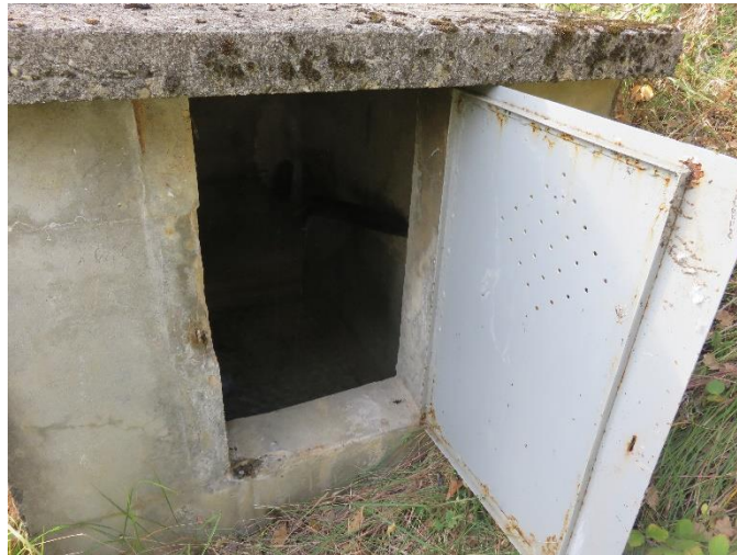
Figure 15 : Photographie de l'entrée du regard de réunion des eaux issues des sources n°5 et n°6.
