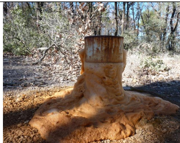
L'adjonction de mousse facilite la foration, cette mousse ressort par l'ancien forage Rondoline
