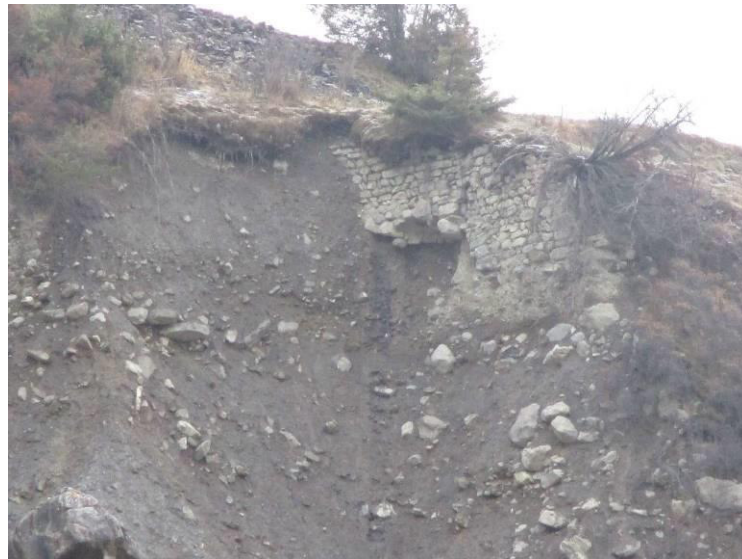
Berge érodées par le torrent en rive gauche à l'amont du barrage communal
