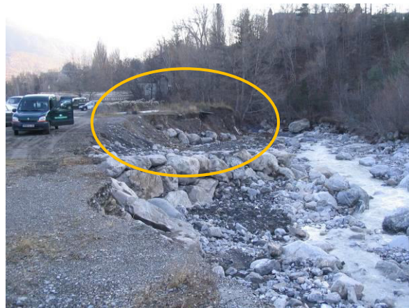
Erosion de la berge au niveau de l'entonnement du pont Zone 3 à enlever – retrait de la berge
