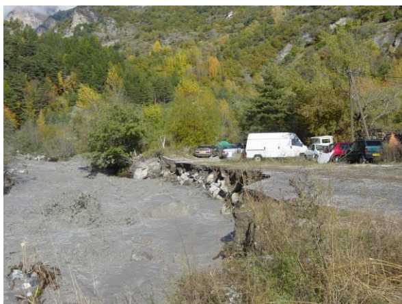
Erosion de la berge rive gauche au niveau du garage crue de 2006
