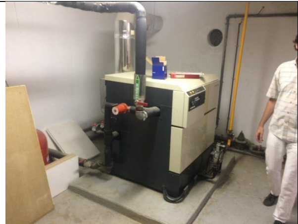
Chaufferie gaz de l'archeveché
