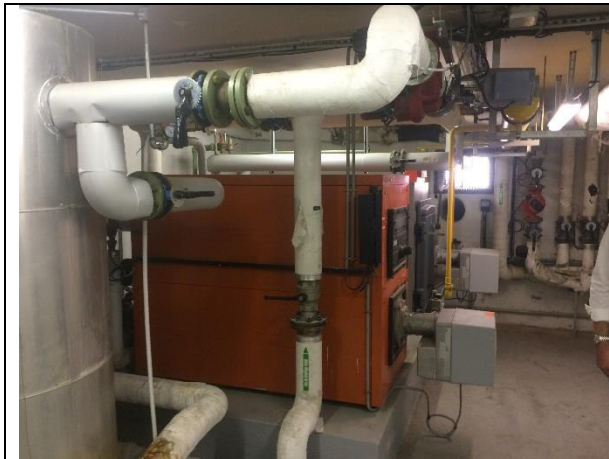
Chaufferie gaz sous la chapelle
