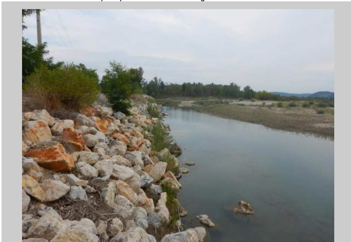
1. Vue de la berge enrochée au niveau de la protection d'urgence réalisée en 2013
