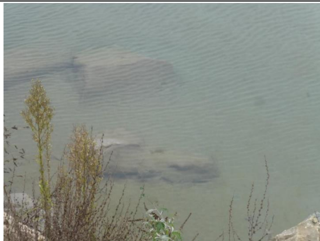
Pied de l'enrochement recouvert d'une épaisseur de sédiment fin
