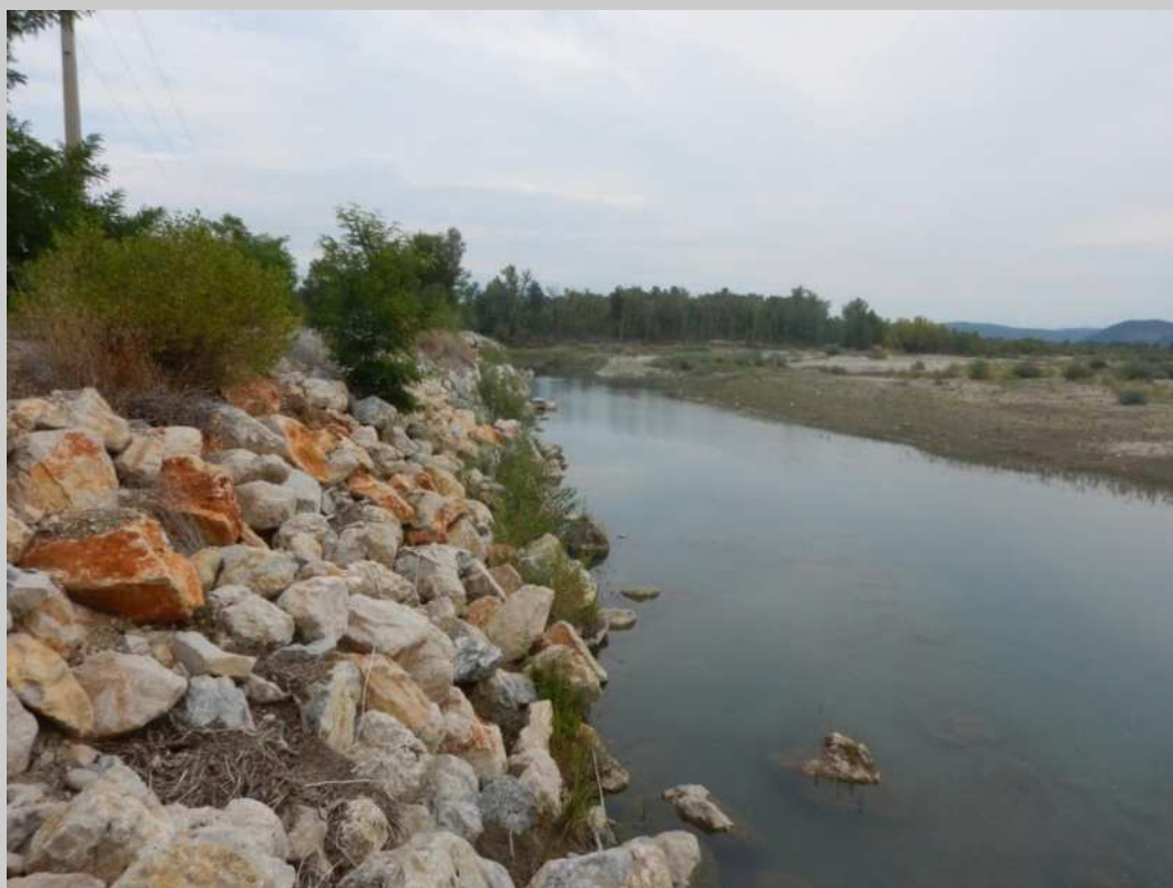
1. Vue de la berge enrochée au niveau de la protection d'urgence réalisée en 2013
