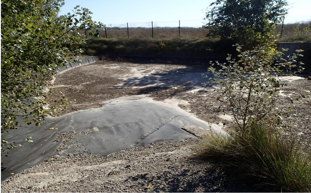
Figure 33 Photographie d'une vue sur le bassin de rétention (source : ECOTONIA)
