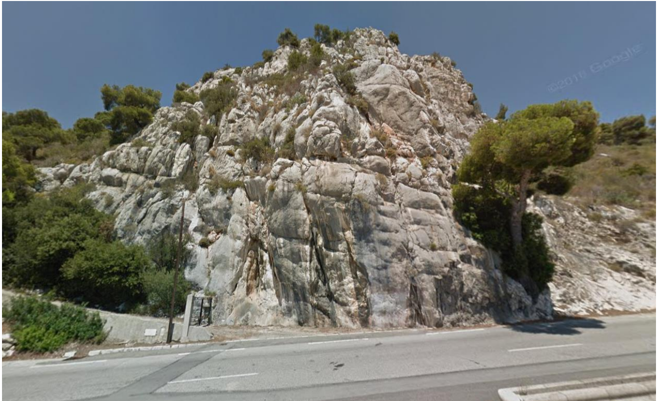
Falaise à sécuriser
