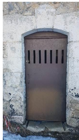
Figure 7: Porte métallique empêchant l'accès aux étages du bas pour les Chiroptères (© M. DAVAL - GCP)
