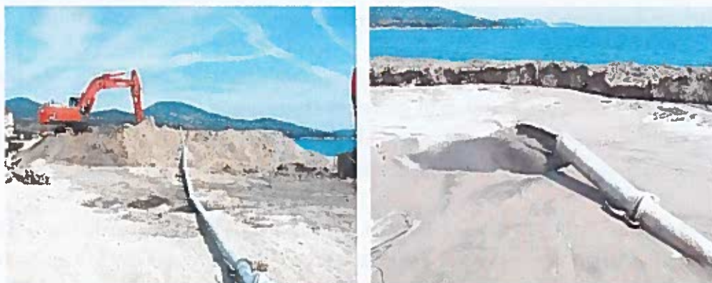
Bassin de décantation et conduite de refoulement de la drague (photos Port Grimaud 1)
