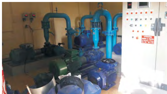
D. Pompes et armoire électrique
