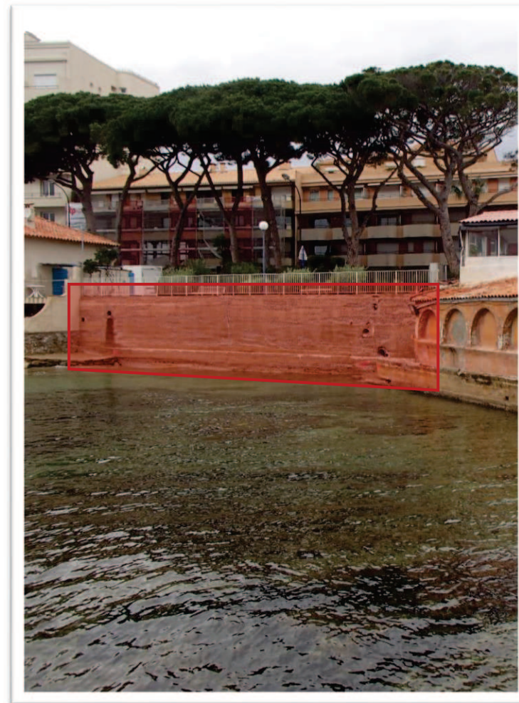
- Photo n°6 _ Mur à protéger -
