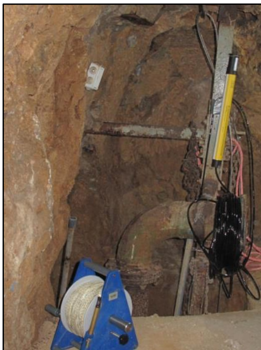
Illustration 49 - Installation d'une centrale Orpheus Mini à la source des Avens (cliché BRGM).
