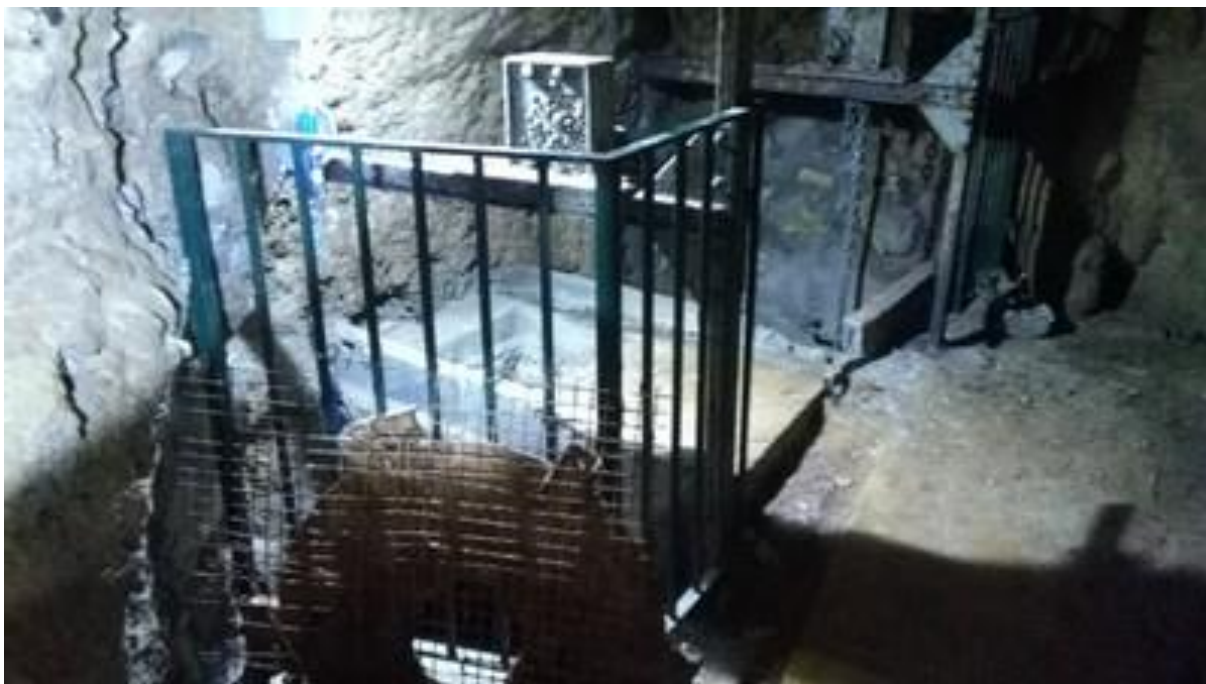
Figure 26 : photographie des installations de captage de la source des Avens (ICEA, 02/09/2016)
