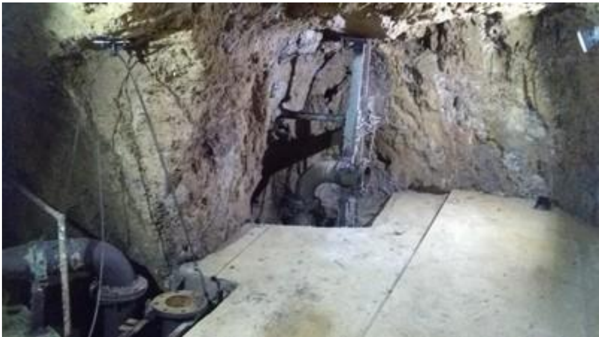
Figure 25 : photographie des installations de captage de la source des Avens (ICEA, 02/09/2016)
