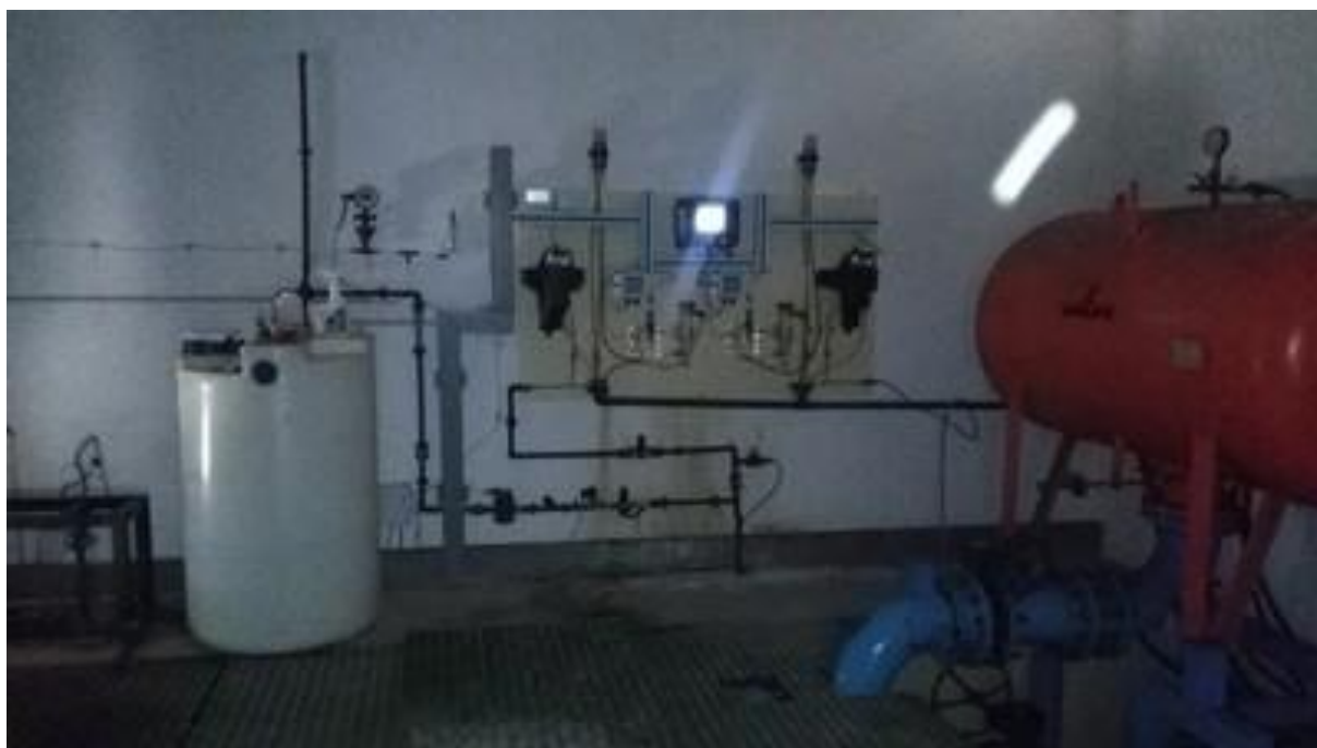
Figure 30 : photographie des installations de traitement (ICEA, 02/09/2016)
