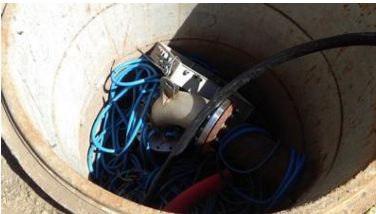
Figure 23 : photographie du forage F1 (ICEA 02/09/2016) - le regard était ouvert en raison d'un dysfonctionnement de la pompe
