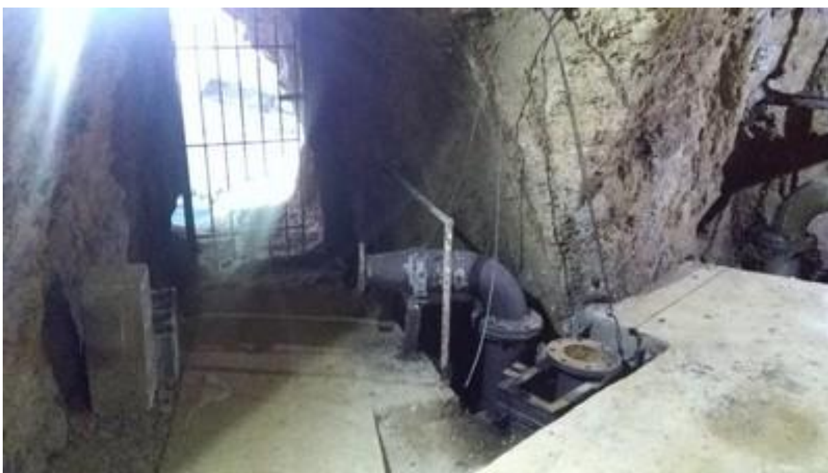
Figure 27 : photographie des installations de captage de la source des Avens (ICEA, 02/09/2016)
