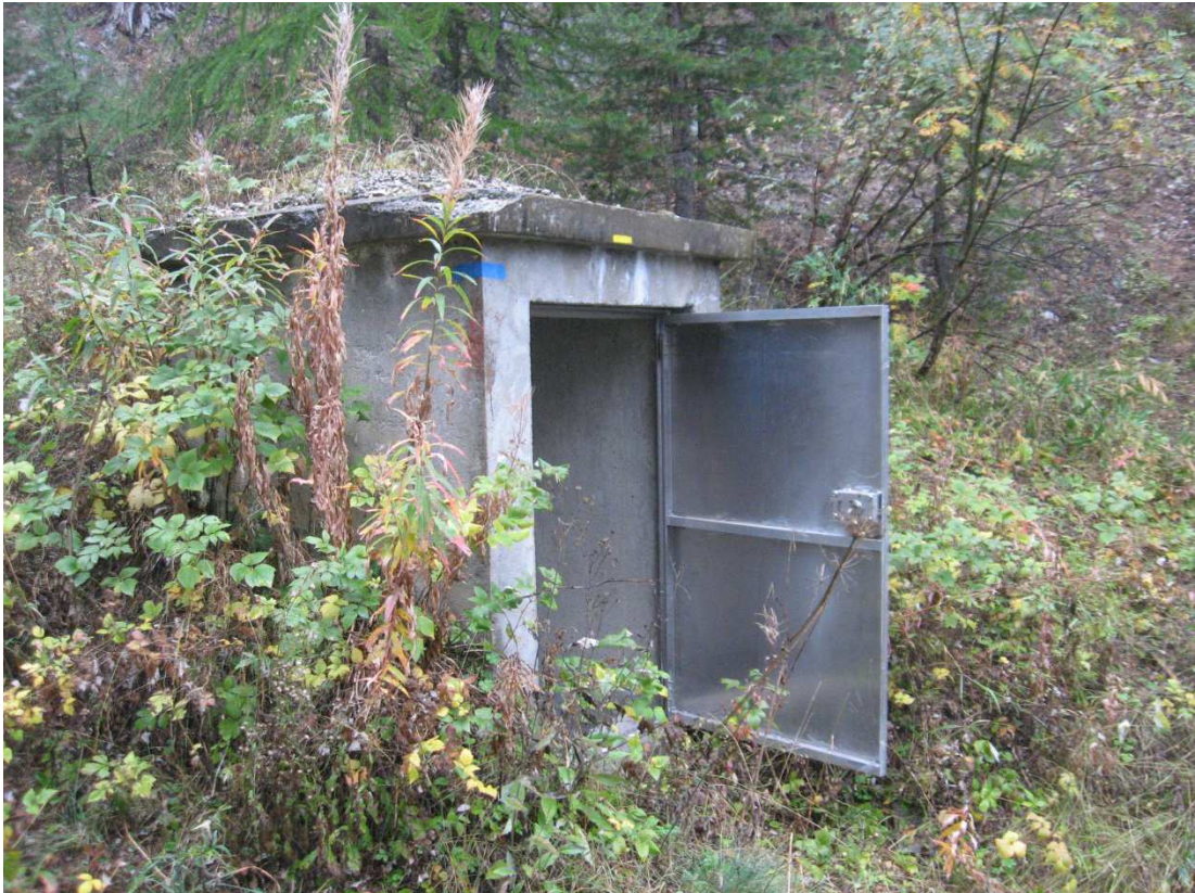
Photo de l'ouvrage de réunion des captages amont et aval
