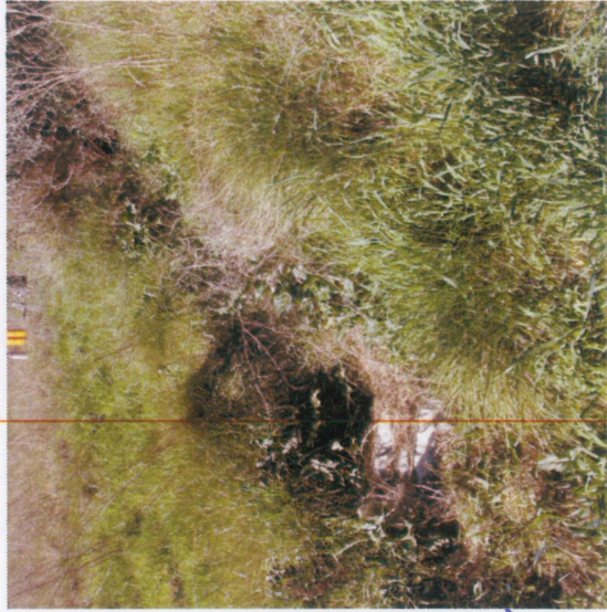
3 - Fossé en terre enherbé
