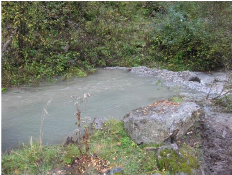
Photo 10_Exemple de bassin de décantation (Réalisation du captage de Vérachous)
