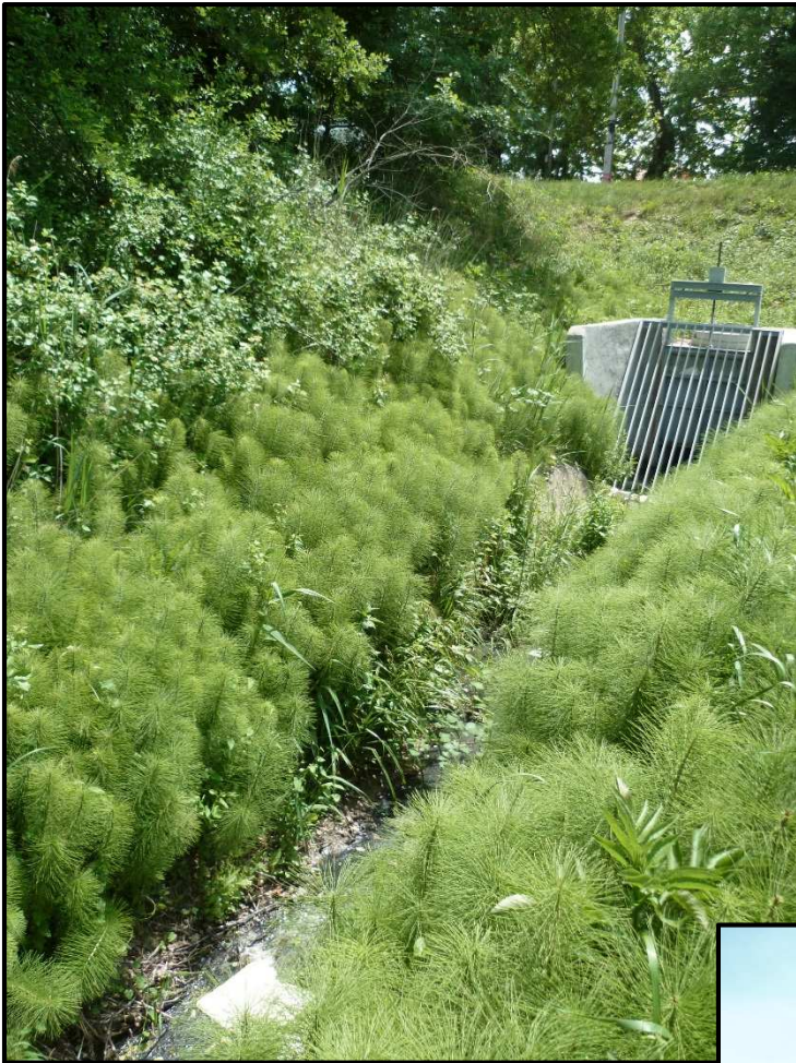
Photo 3 - Mayre de la zone industrielle à la sortie du bassin de rétention (mai 2015)
