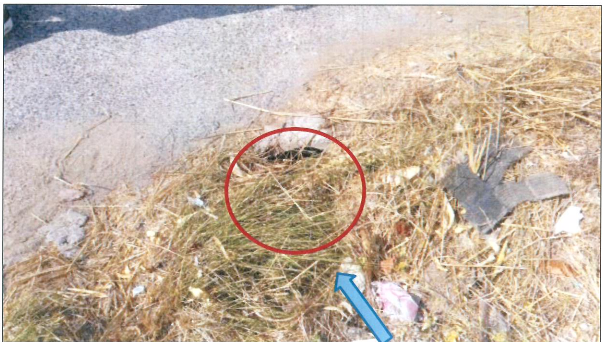
Figure 12 : Exemple d'un ouvrage circulaire sous le chemin de la Poterie très mal entretenu (OH n°2)
