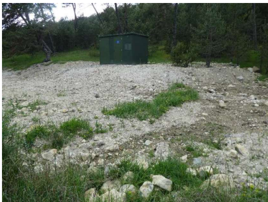
Poste électrique récemment construit à l'emplacement d'une pelouse subméditerranéenne mésoxérophile d'intérêt communautaire.
