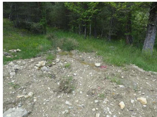
Terrassement ayant impacté un habitat humide.
