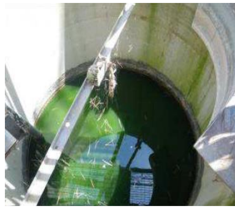
Poste de relèvement
