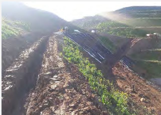
Couverture du site 4 : réalisation d'une tranchée d'ancrage pour pose de géotextiles d'étanchéité
