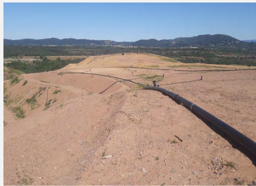
Couverture du haut du site 4 finalisée avec réseau de captage du biogaz avant revégétalisation
