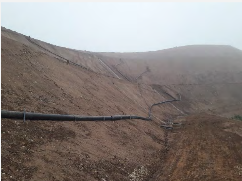
Couverture du site 4 : remise en place du réseau de collecte du biogaz
