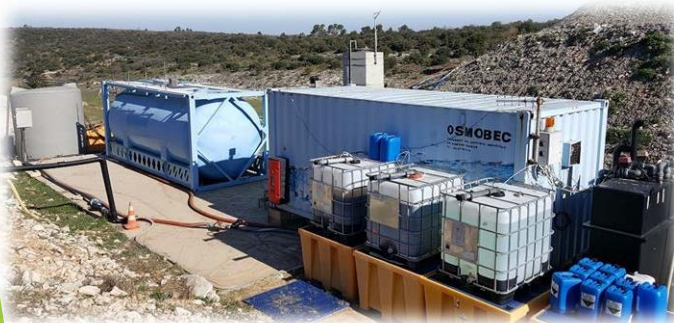
Unité de traitement des lixiviats
