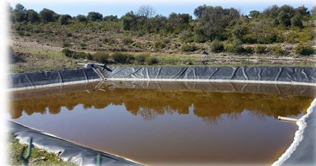
Bassin rétention eaux de ruissellements internes
