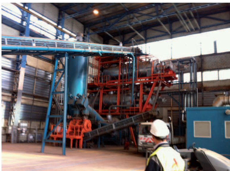
Vue générale de l'unité de désorption thermique
