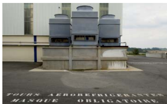
Tour Aéroréfrigérante (TAR)
