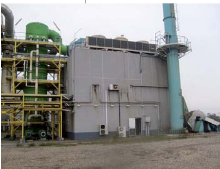
Laveur des gaz de combustion à SOLAMAT Fos
