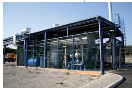
Régénération de solvants - Unité d'incinération de COV à Peyruis (04)
