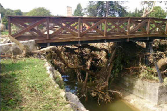
Obstruction totale d'une passerelle étroite par un embâcle (Biot – 06)
