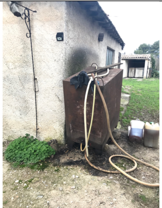
Cuve à fioul aérienne "3"
