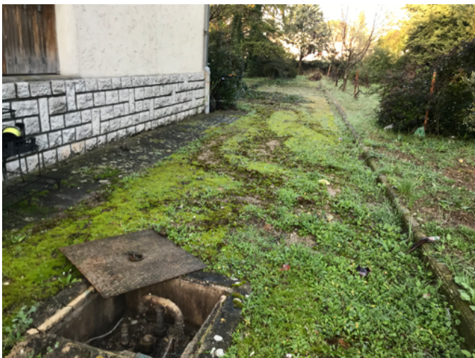
Cuve à fioul enterrée "4" au Nord du bâtiment "G"
