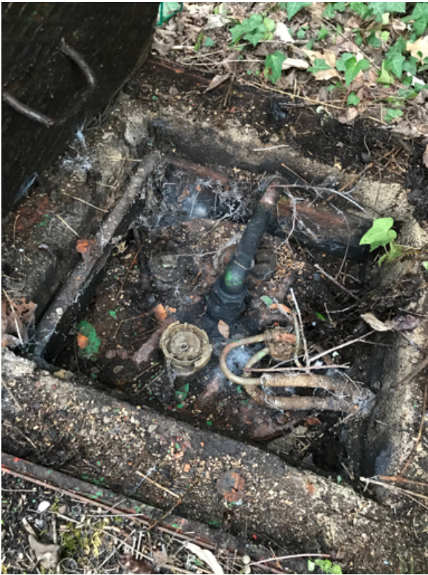
Cuve enterrée à fioul "1" au Nord du bâtiment "A"
