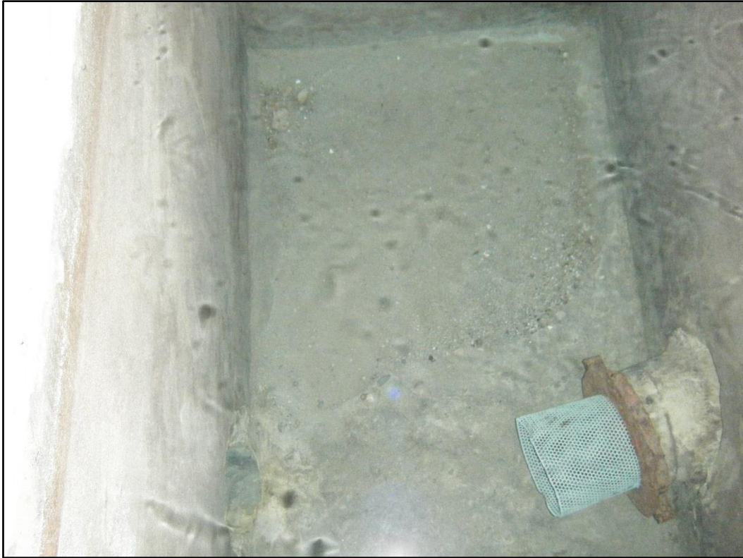
Arrivée des eaux captées et départ des eaux en distribution (départ crépiné à droite de l'image)
