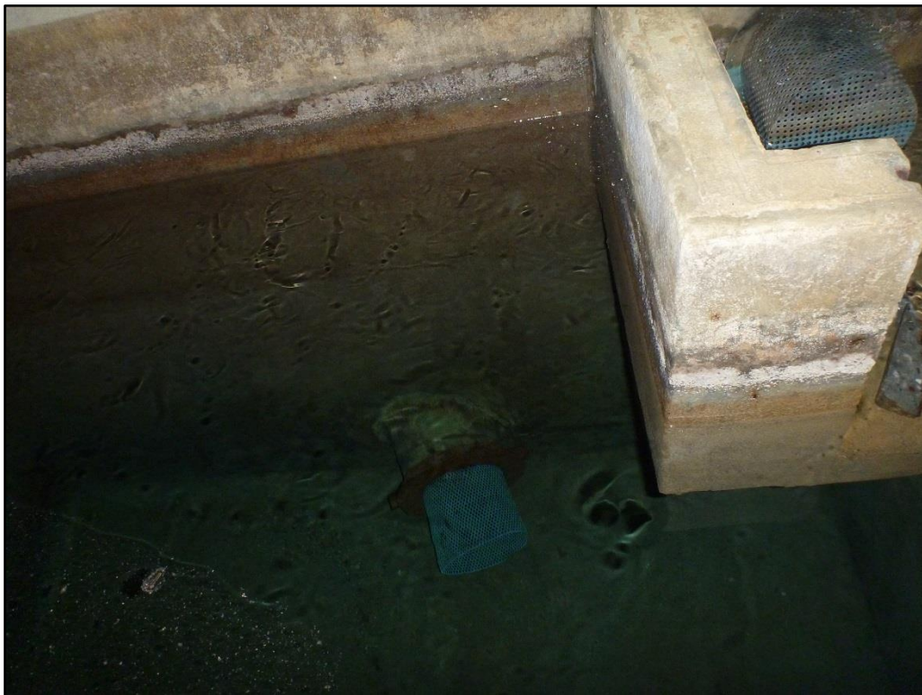
Départ des eaux en fond de bac de prise et départ du trop plein
