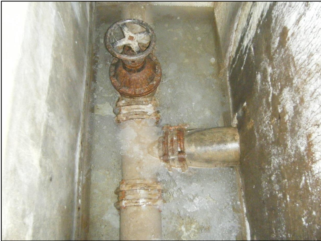
Arrivée des eaux captées et coude vers le bac de prise. Présence d'une vanne de vidange.
