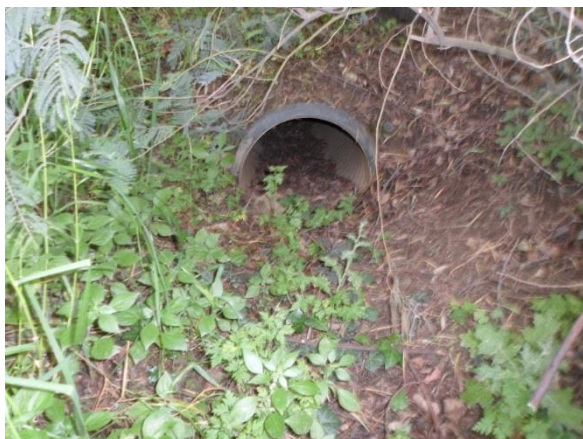
Figure 12 : Conduite \Phi 400 mm récupérant les eaux des deux fossés
