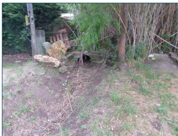
Figure 8 : Fossé et buse \Phi 400 mm en entrée du camping
