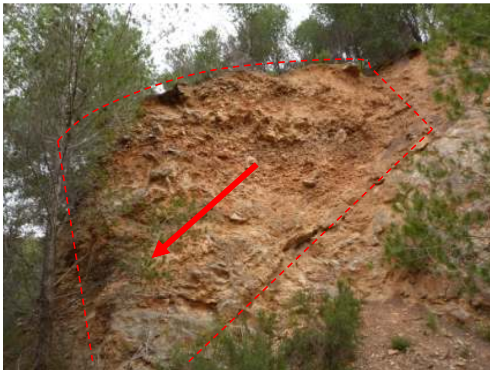
Photographie n°29 : Paquets de brèches (60 à 80m3) menaçant de s'effondrer
