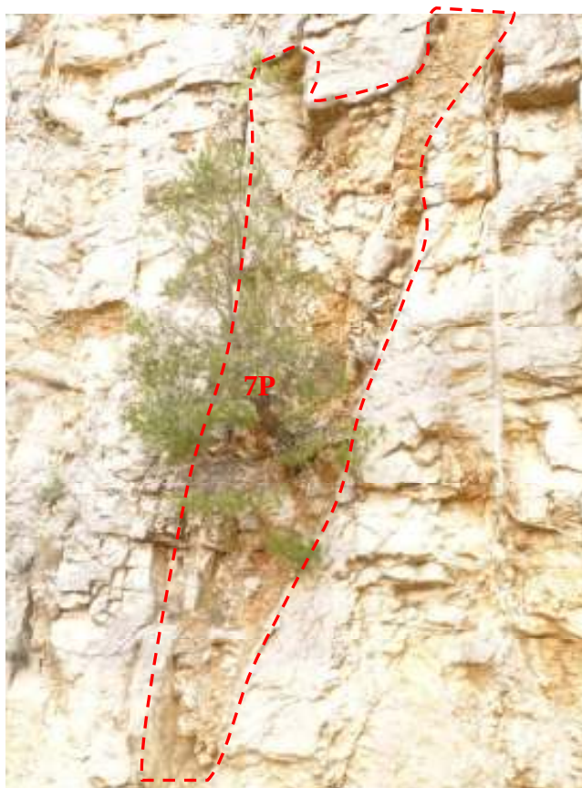
Photographie n°64 : Brèche 7P composée de pierres et de phase de liaison argilo sableuse, se lessivant
