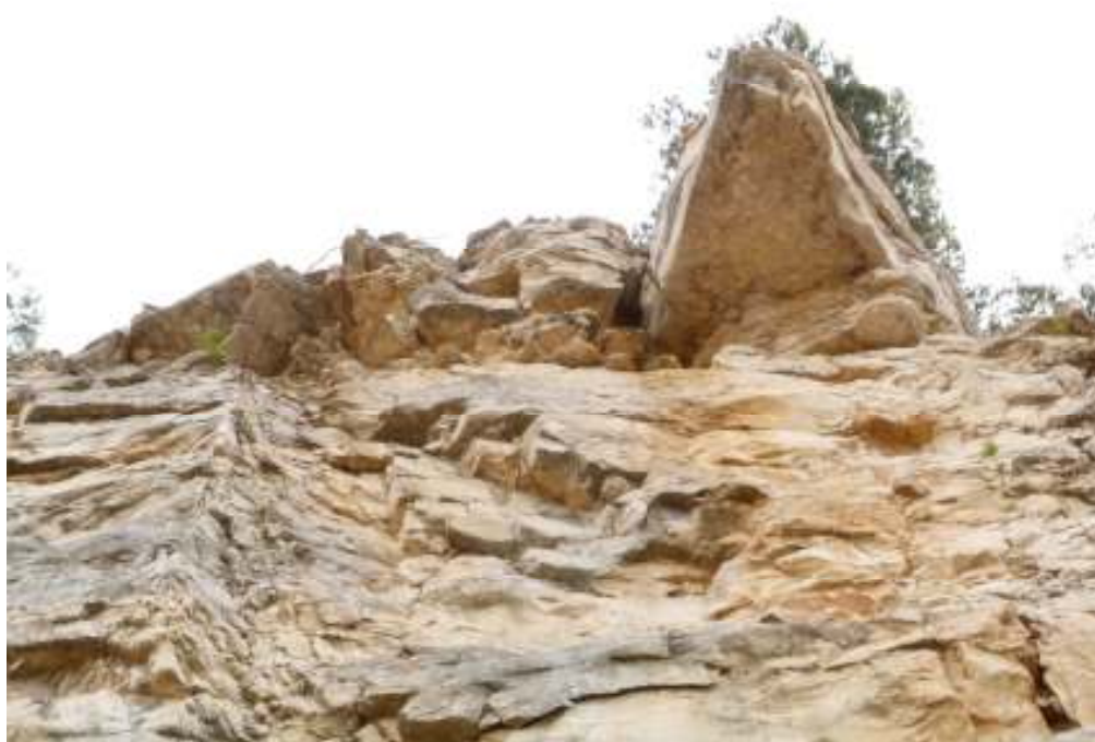
Photographie n°45 : Aperçu du surplomb de l'ensemble 7C
