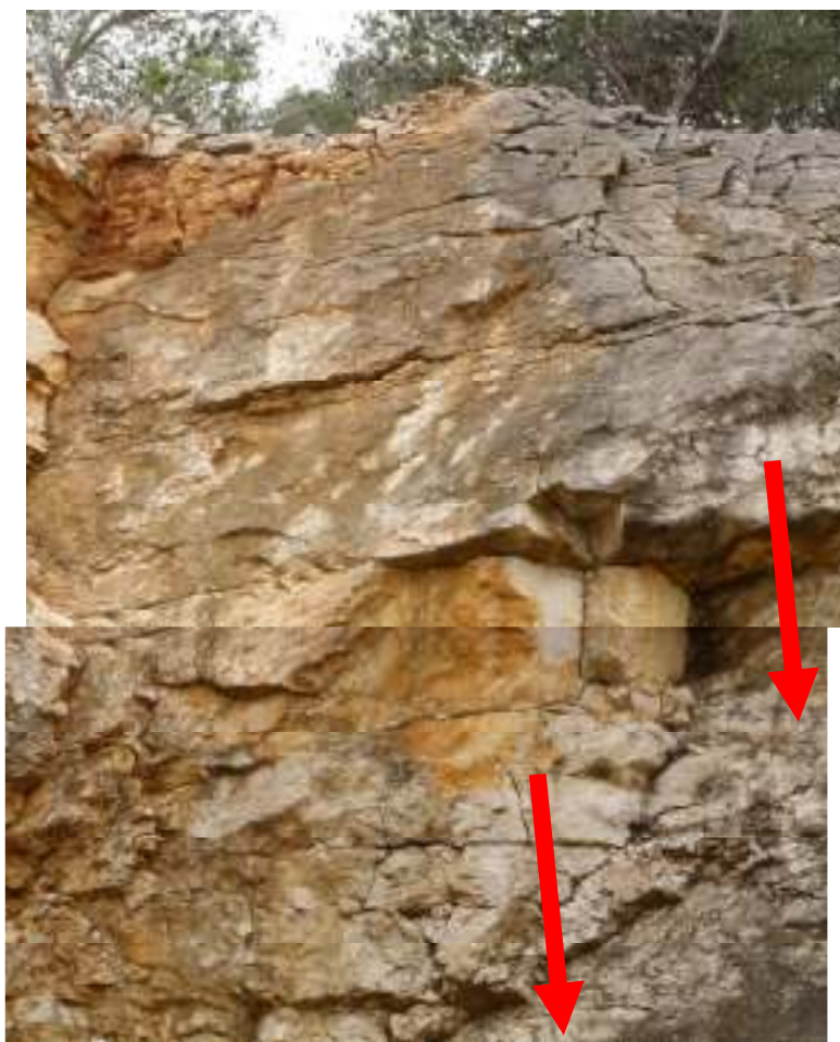
Photographie n°79 : Possibilité de chute de blocs par rupture de surplomb au droit de la plaque 7V
