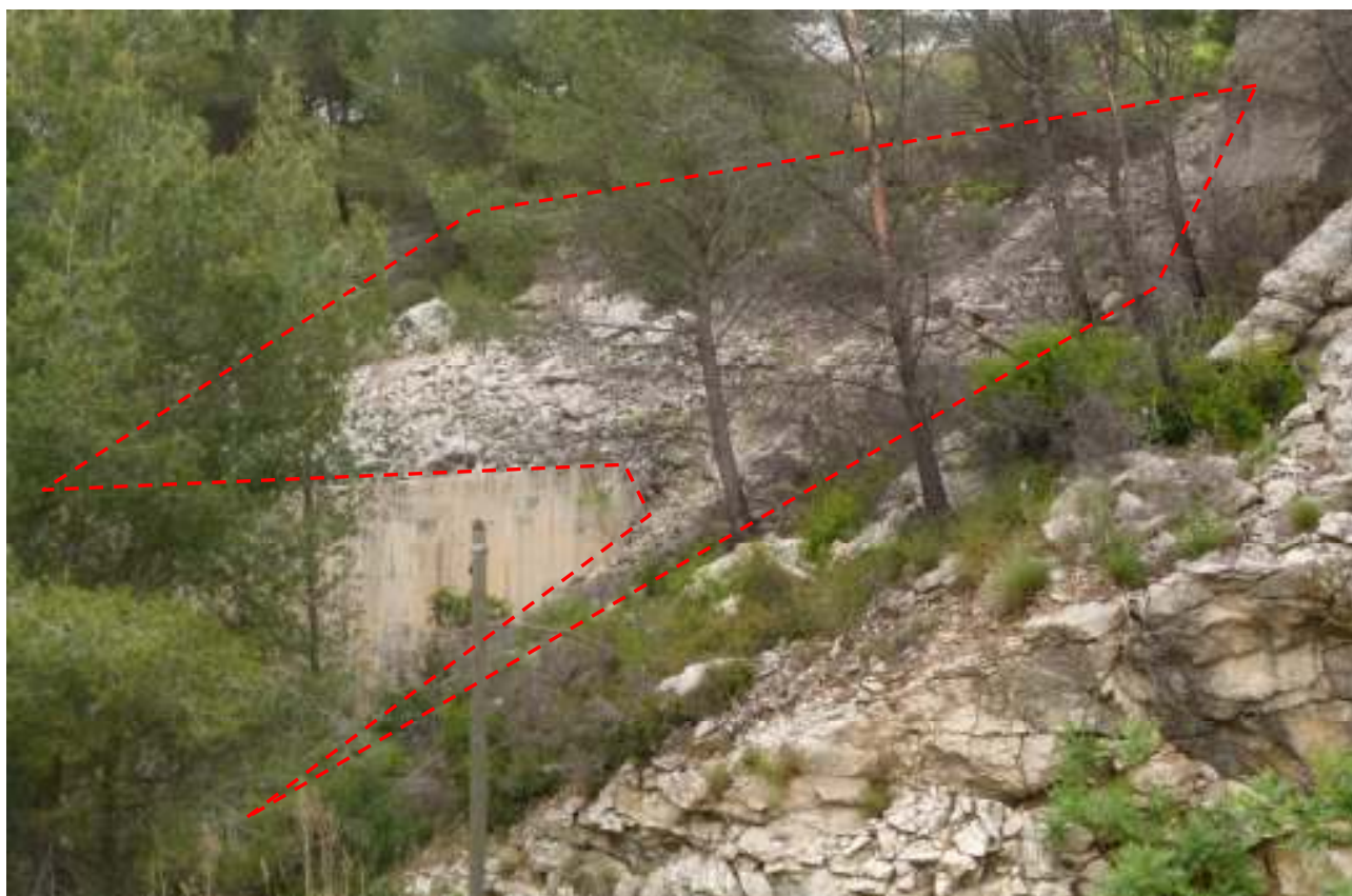
Photographie n°23 : Remblai blocailleux situé au dessus de l'ouvrage hydraulique à l'extrémité Nord du secteur
