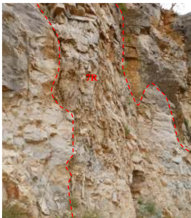
Photographie n°69 : Pied de l'ensemble 7R, très altéré
