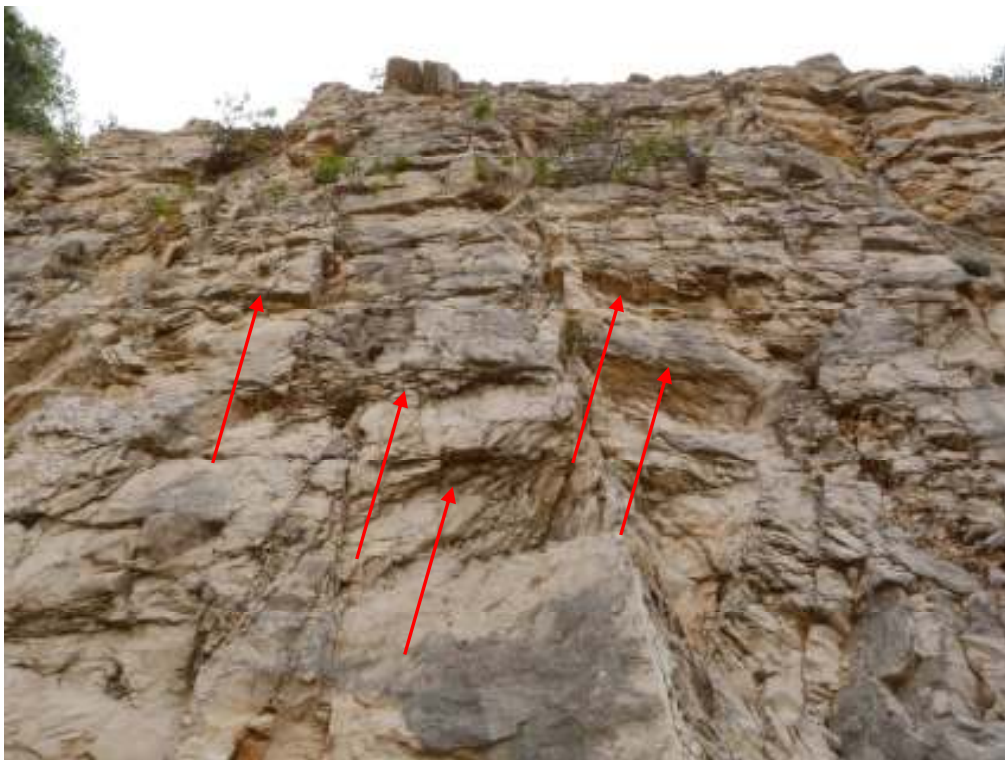
Photographie n°58 : Ecaillage superficiel visible en surface de talus 7L (nombreuses plaques d'1 à 2 m 3 )
