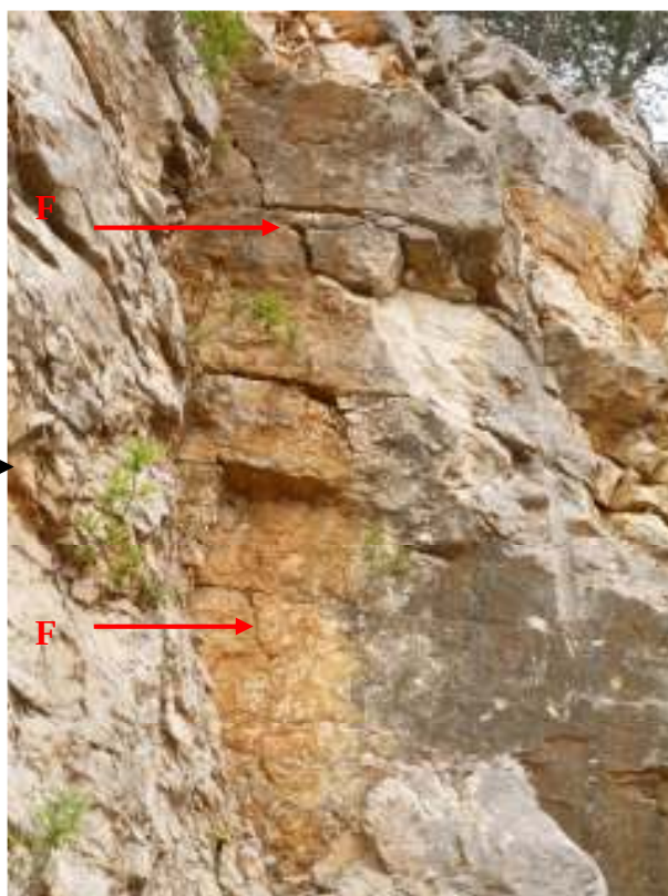
Photographie n°72 : Fissures de rupture visibles sur l'un des plans de diaclase
