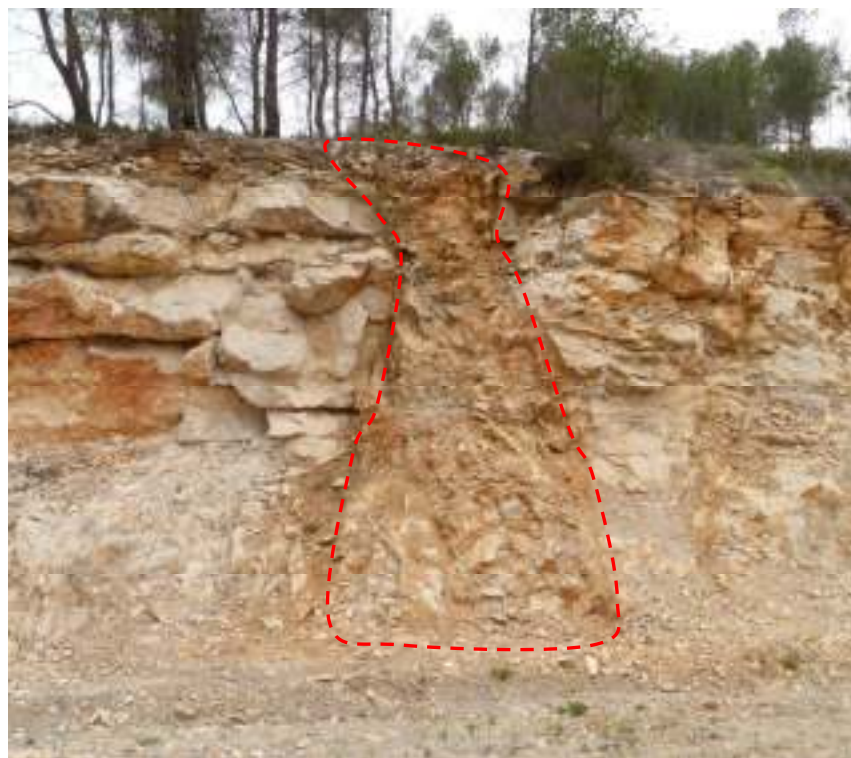
Photographie n°04 : zone de brèche visible au droit du secteur
