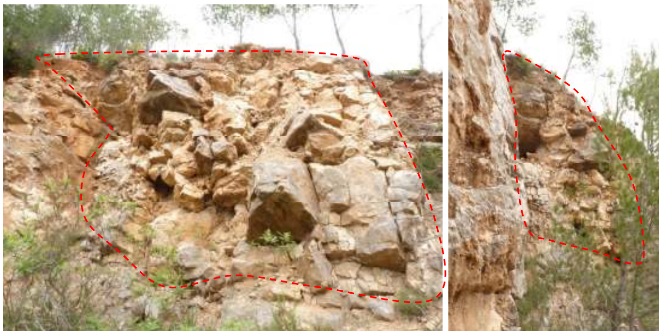
Photographies n°30 et 31 : Portion calcaire située dans l'éboulis du secteur 4 présentant un paquet rocheux désolidarisé du massif et menaçant de s'effondrer
