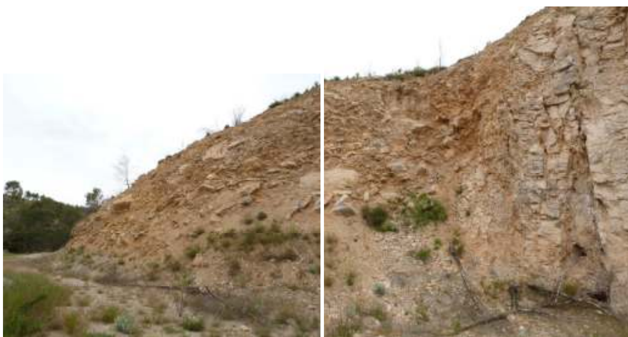
Photographie n°37 : Eboulis consolidé constitué de b blocs (localement >1m 3 )
