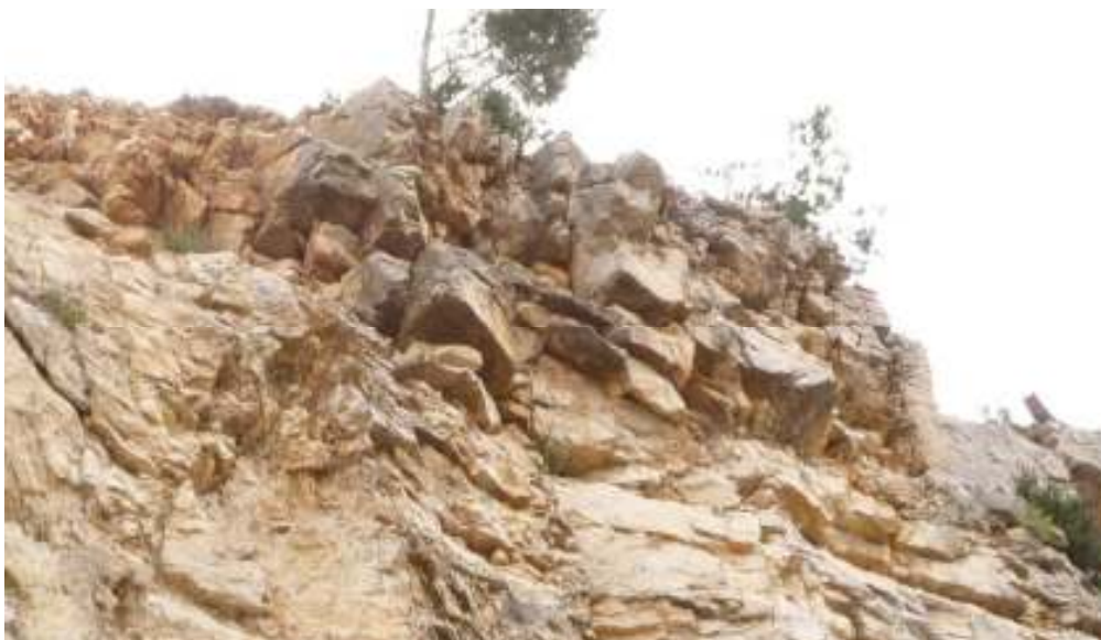
Photographie n°43 : Aperçu du surplomb et de l'état morcelé de la frange sommitale 7B
