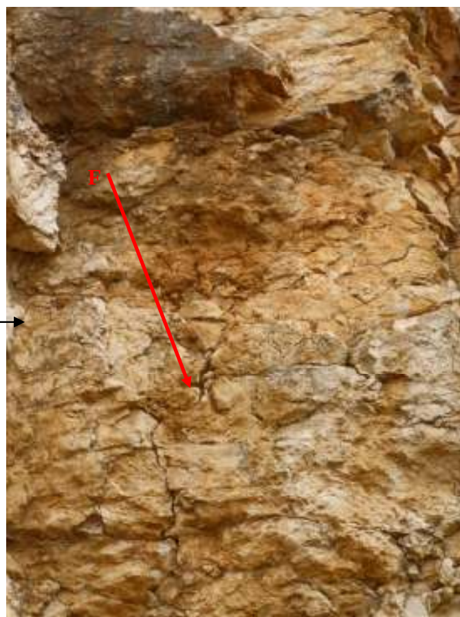
Photographie n°77 : Aperçu de fissure de rupture visible dans la plaque 7U
