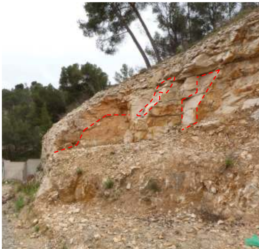
Photographie n°01 : plan de rupture visible dans le talus
