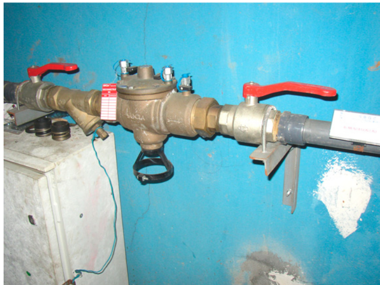
Disconnecteur sur l'arrivée d'eau potable
