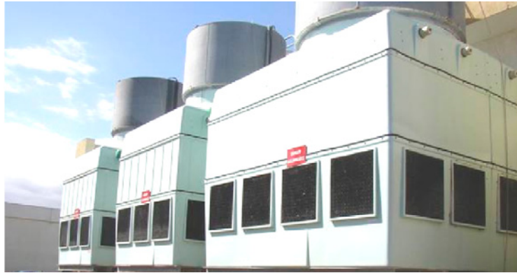
Les trois tours aéroréfrigérantes de l'installation
